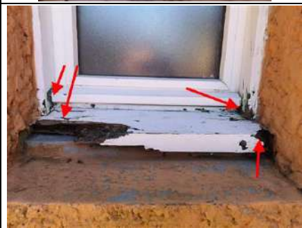
Photo n° PhTer004 Localisation : Wc Ouvrage : Fenêtre et cadre (F1) - Bois et Peinture Parasite : Présence d'indices d'infestation d'agents de dégradation biologique du bois Indices : altérations dans le bois (présence sur une partie de l'élément)
